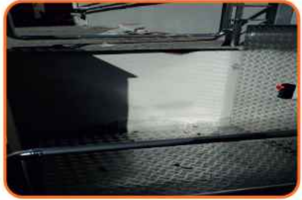
ENGELLİ MEKANİK PLATFORM KONTROLLERİ
