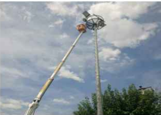
Pamukçu Belediye Önü Aydınlatma
